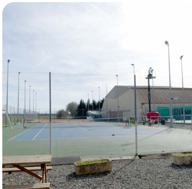
La société en charge des travaux met en place les nouveaux éclairages.
